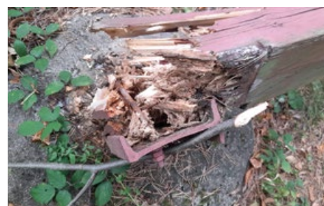
Detail poškození Červeného kříže
