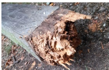
Detail poškození kříže z vyhlídky
