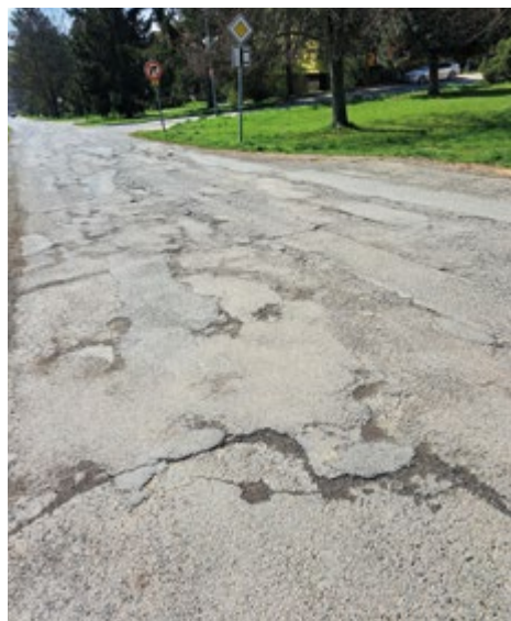
Současný neutěšený stav Řevnické ulice
