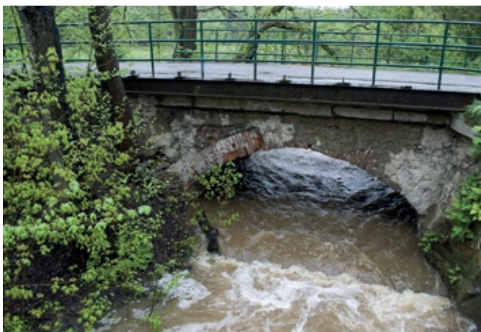
Hráz Prostředního rybníka je v havarijním stavu
