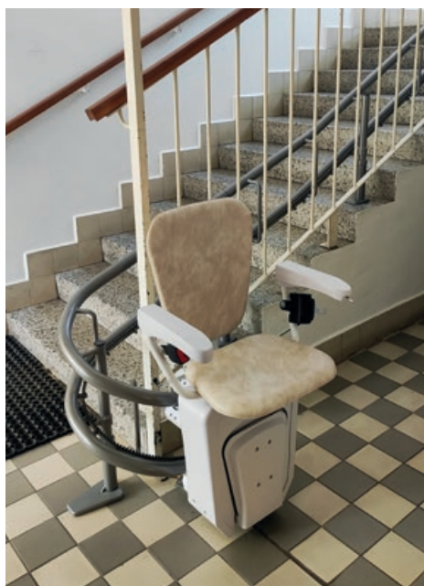
Zařízení parkuje v přízemí vedle schodiště
