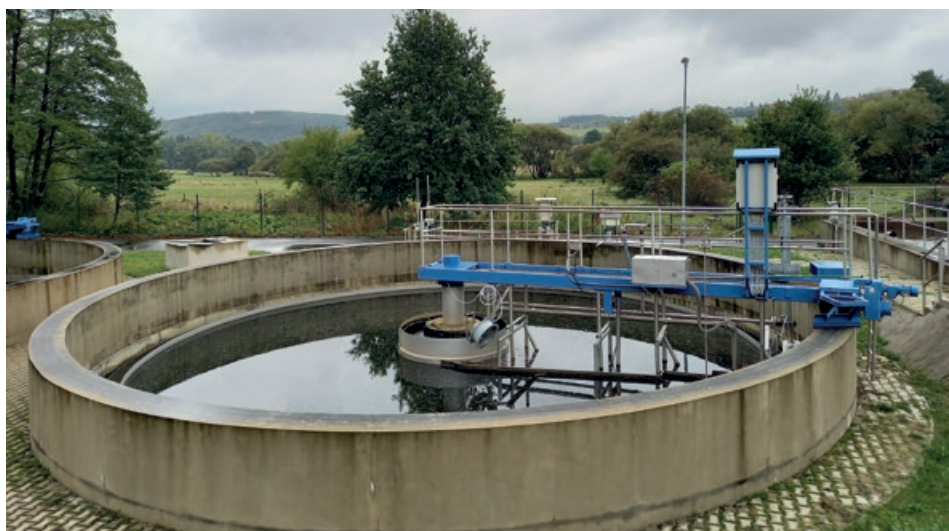
Mníšická ČOV se nachází v areálu Kovohutí
