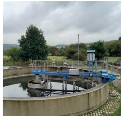
Mníšecká čistírna odpadních vod je v areálu Kovohuti
